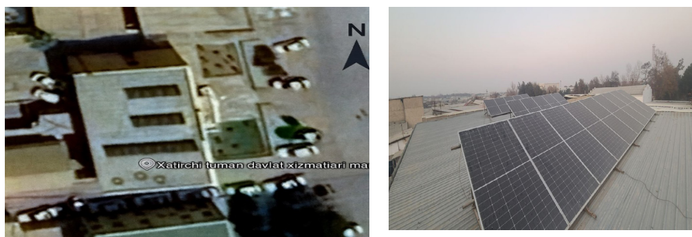
Рисунок 1. Спутниковый снимок с видимым расположением СФЭС мощностью 10 кВт на крыше единого окна Хатырчинского района 1
